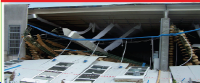
Struttura crollata dopo evento sismico 0,10-0,15 g CLASSE SISMICA 3
