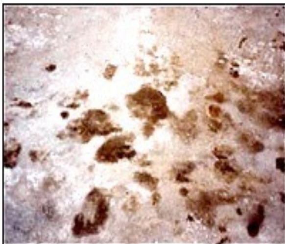
Olio e grasso incrostati nel calcestruzzo
